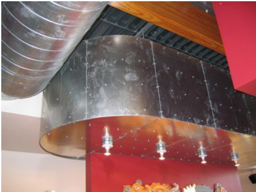
Figura 1 – Marcas de impressão digital e manuseio em dutos galvanizados expostos
