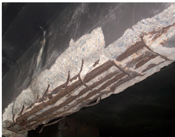
A corrosão também pode atingir vigas de concreto armado
